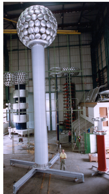
屋外用1200kV および 屋内用600kV コンデンサ
